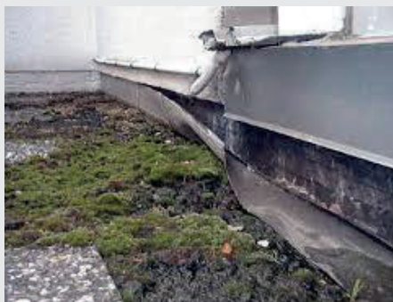
Décollement de relevé d'étanchéité de toiture terrasse.
