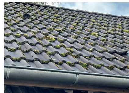
Défaut d'entretien (végétaux)
