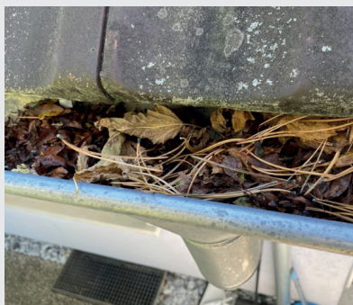
Engorgement de descente d'eau pluviale (obstruction par végétaux).
