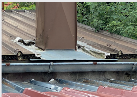
Mise en œuvre « bricolée » (ici au niveau de l'abergement de cheminée).
